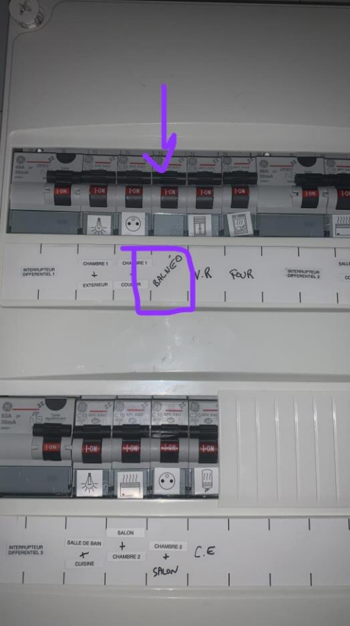
Etape 1 Mettre la Balnéo ON dans le compteur à l'entrée
